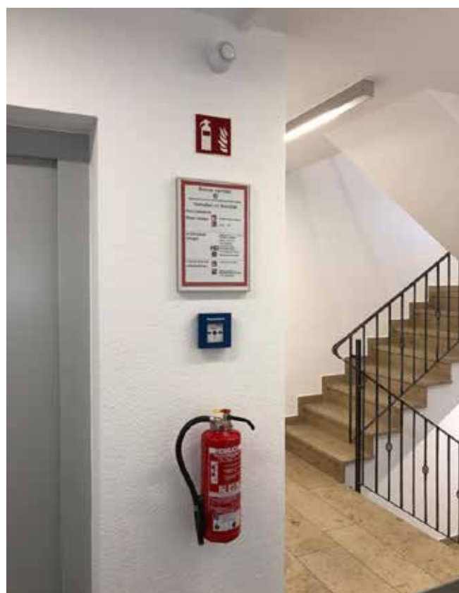
Feuerlöscher mit Hinweistafel, Hausalarm, Hinweistafel Brandschutzordnung, Hausalarmsirene.
